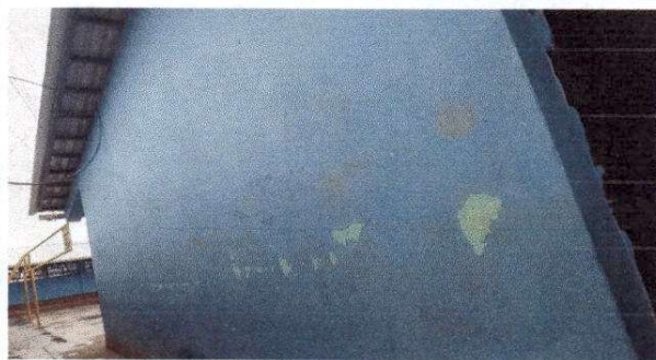
Foto 9: pintura en muros exteriores e inferiores.
